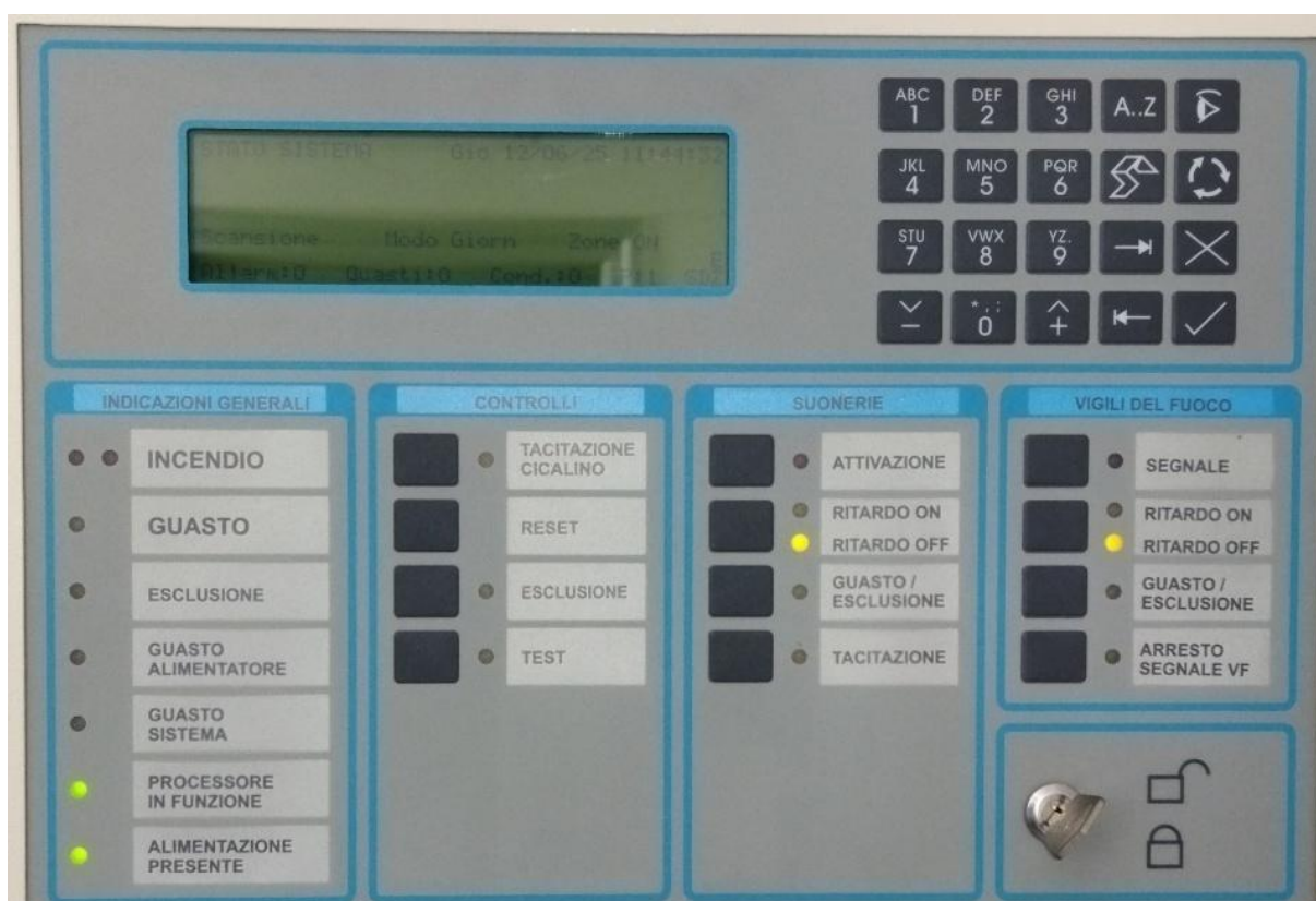
Centralina allarme antincendio camere bianche sensori e semiconduttori
