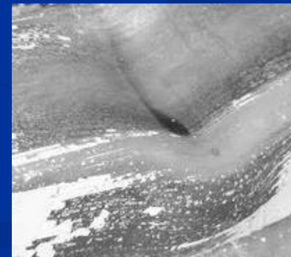
Instabilità' locale nella zona centrale di un controvento a sezione scatolare
