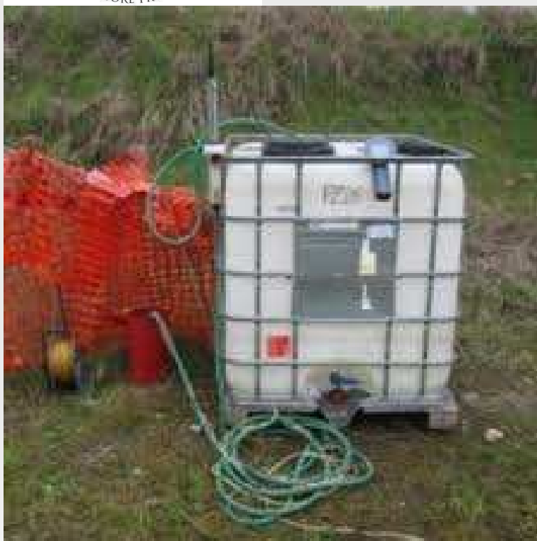
DEPOSITO TEMPORANEO ACQUA EMUNTA
