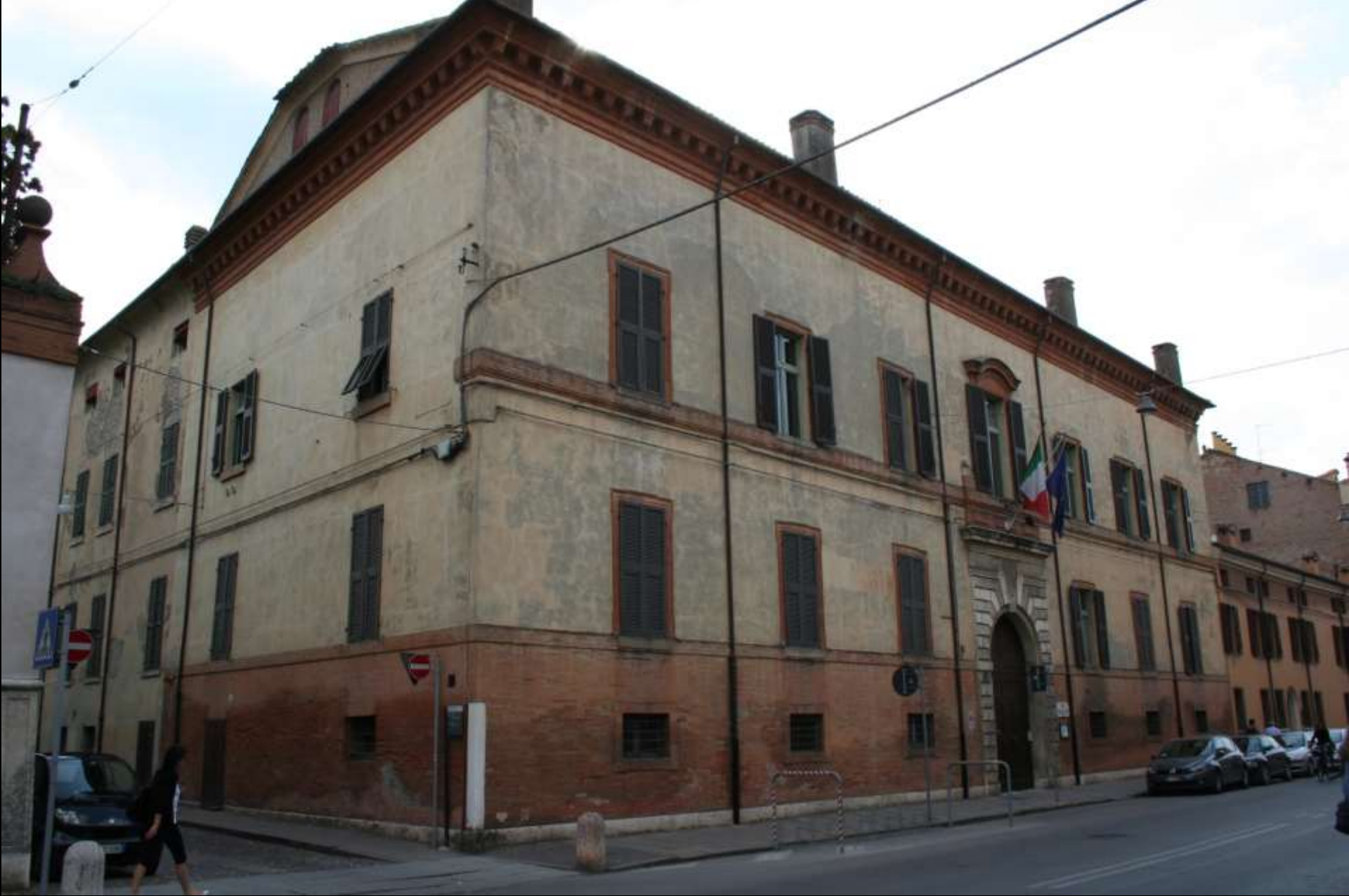
Intonaci cementizi e degrado precoce della tinta di calce additivata con acrilico
