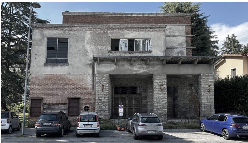
Figura 1. Cinema di Inverigo. Edificio da demolire e ricostruire con nuova destinazione d'uso
