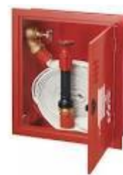
Idrante a muro
